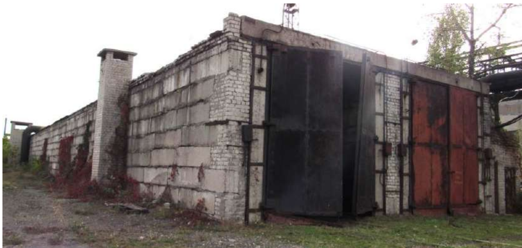
Рисунок 1.6. Будівля, що з 2010 року визнана аварійною та не експлуатується, підлягає списанню та демонтажу, ПрАТ «ДКХЗ», м. Кам'янське
