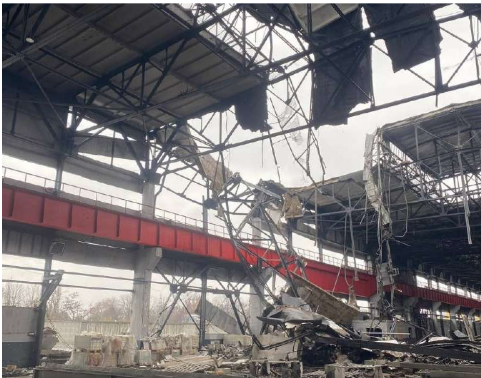
Рисунок 1.3. Суттєво пошкоджені внаслідок влучання ракети каркас, покриття та стінове огороження цеху одного з підприємств в Дніпропетровській області
