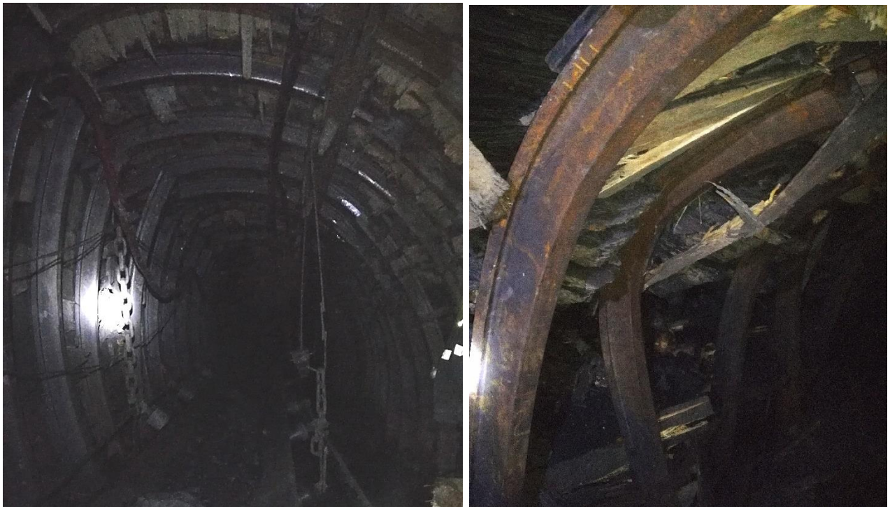
Рис.4.1 Фото руйнувань виробки за візуальними спостереженнями
