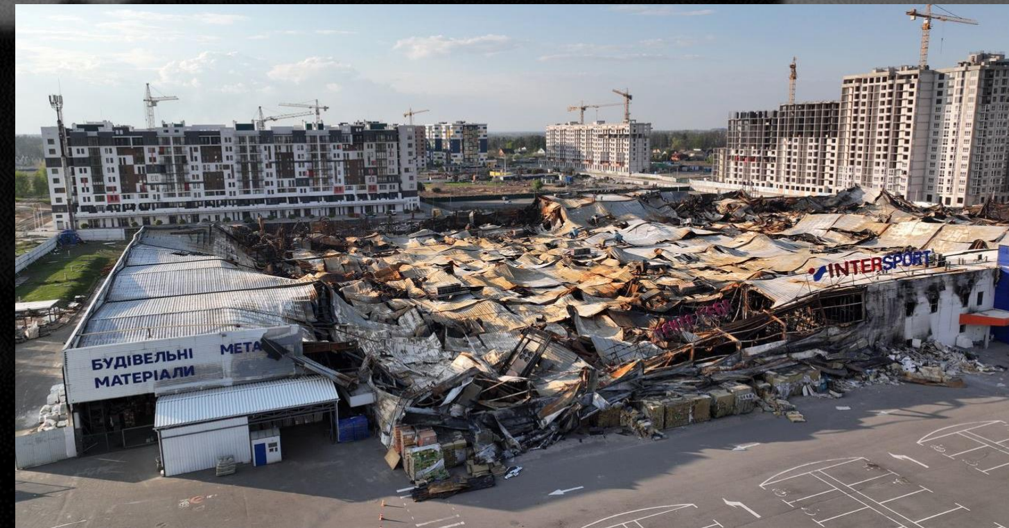
Рис. 2 - Зруйнований дах будівлі
