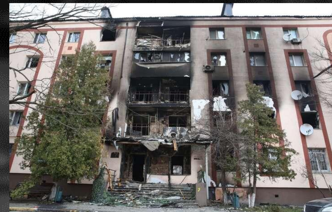
Рис. 12 – Згорілий під'їзд будівлі
