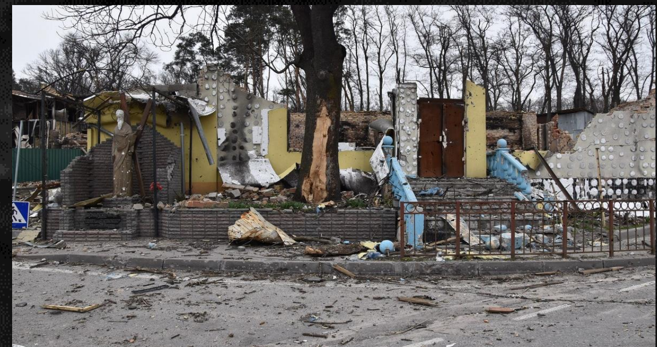
Рис. 27 – Повністю зруйнована будівля, «Променистий»
