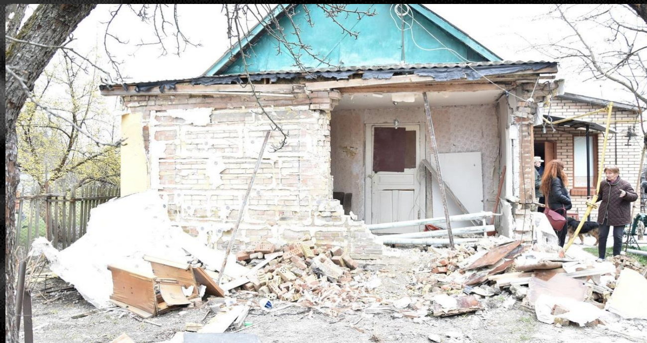
Рис. 22 – Зруйнована стіна після прямого влучення
