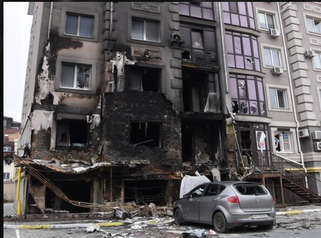
Рис. 9 – Спалена частина будівлі після влучення
