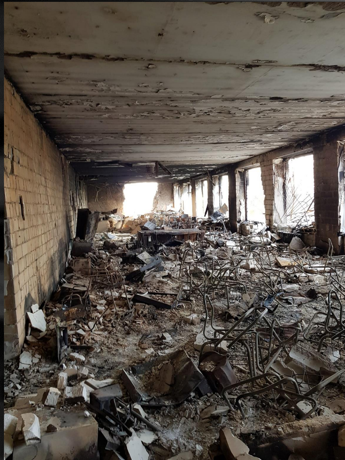
Рис. 18 – Зруйнована їдальня школи
