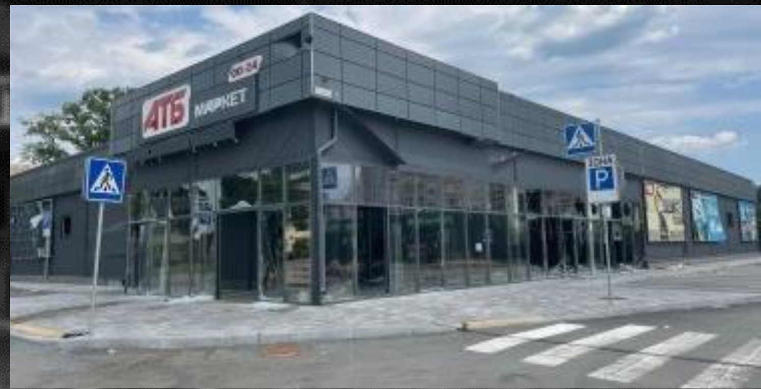
Рис. 14 – Зруйнований фасад магазину АТБ
