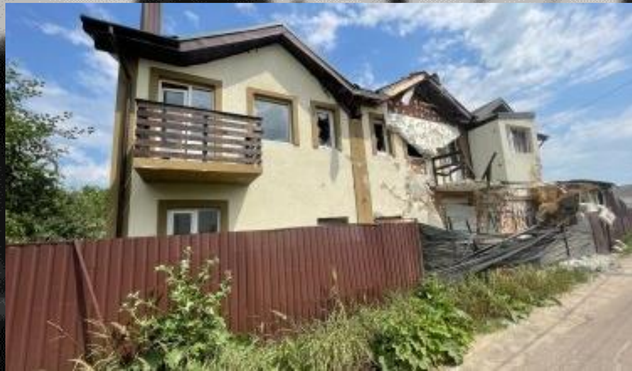
Рис. 20 – Зруйнований фасад таунхаусу
