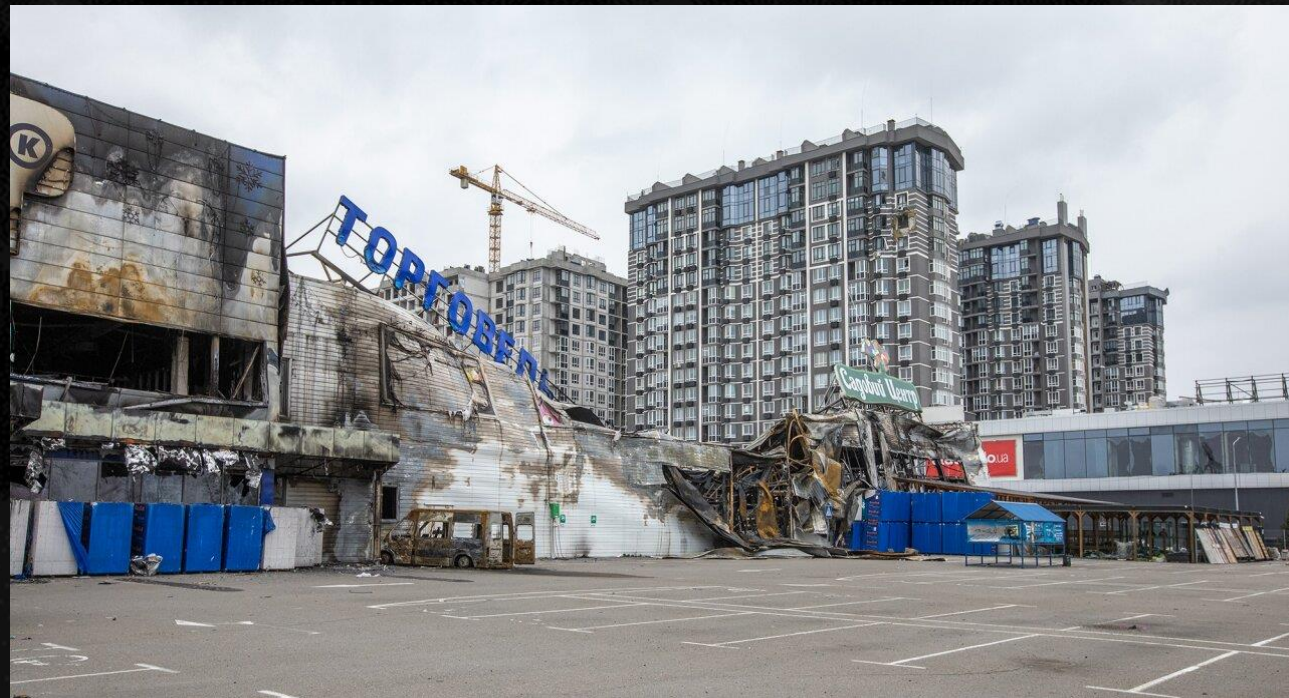
Рис. 3 - Загальний вигляд зруйнованої будівлі
