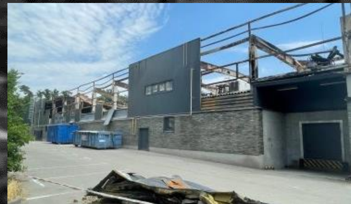
Рис. 16 – Вид зруйнованого заднього фасаду
