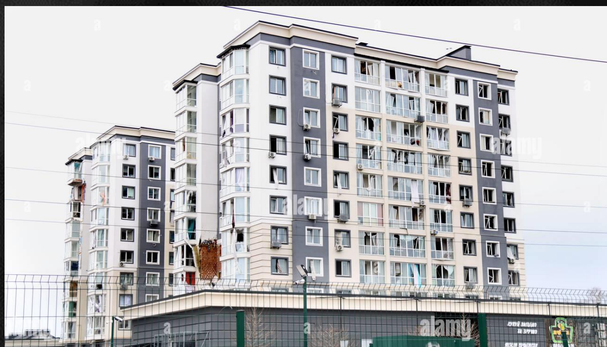
Рис. 7 – Зруйновані вікна на фасаді будівлі
