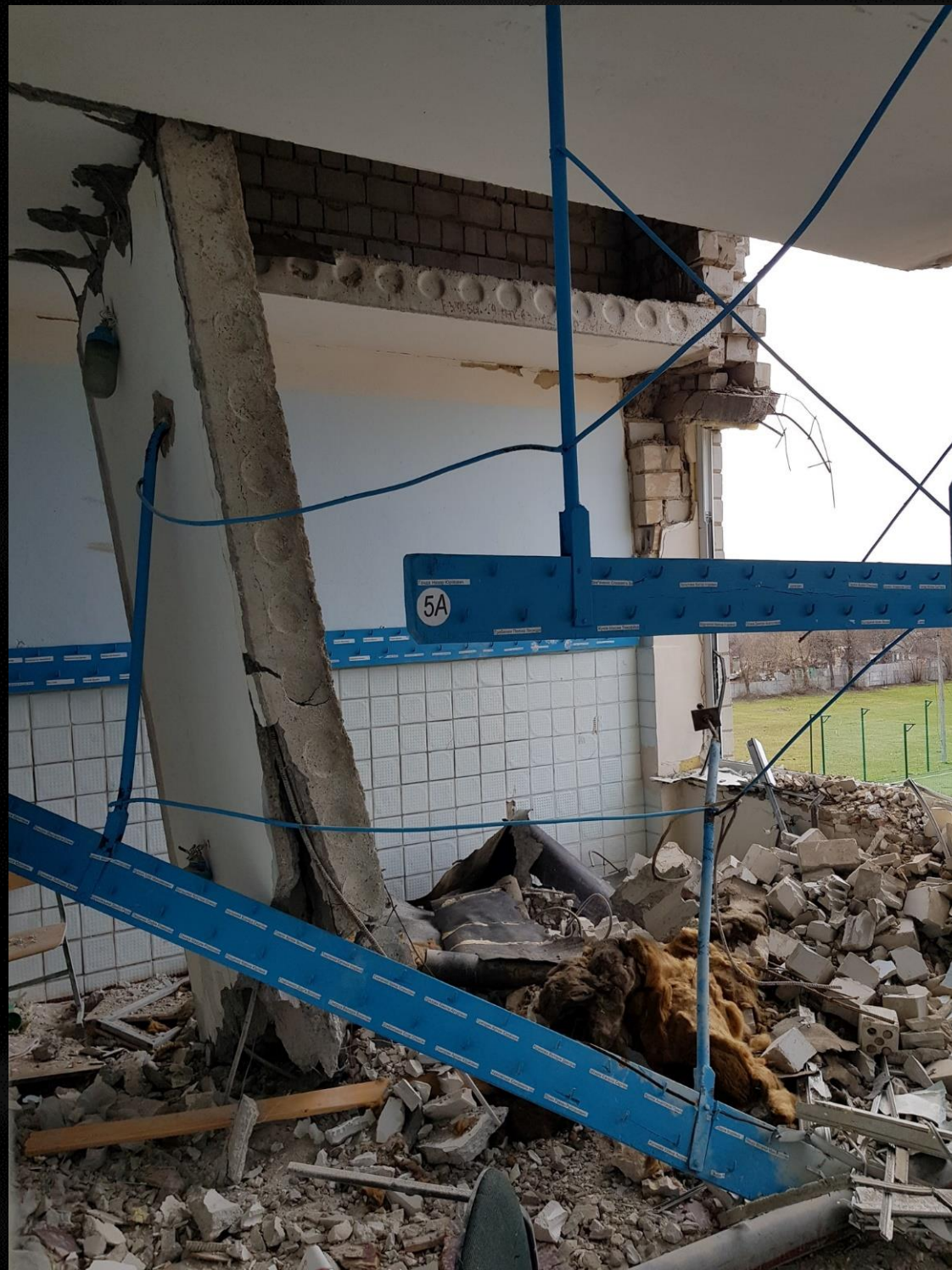
Рис. 17 – Зруйнована плита перекриття
