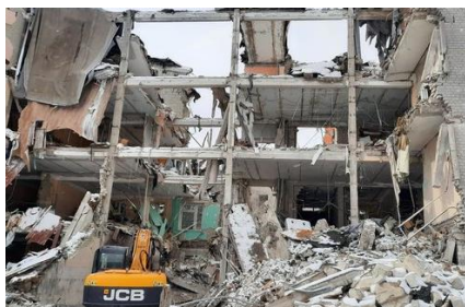
Рис. 1. Зруйнована внаслідок воєнних дій будівля у Харкові (2022 р.)
