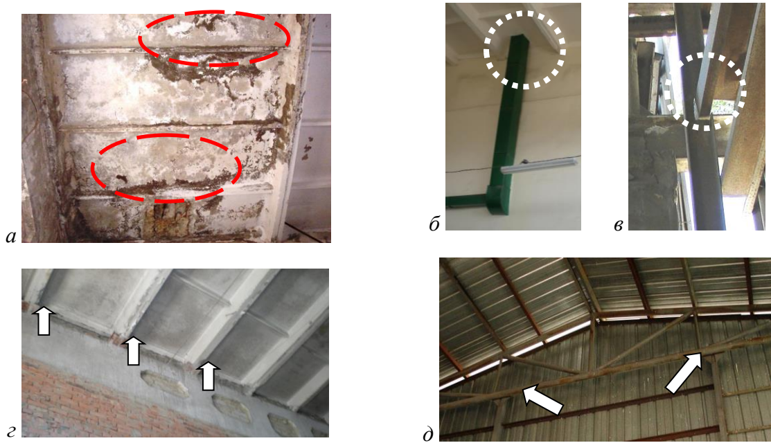
Рис. 1. Пошкодження конструкцій, що приводять до небажаного перерозподілу зусиль
