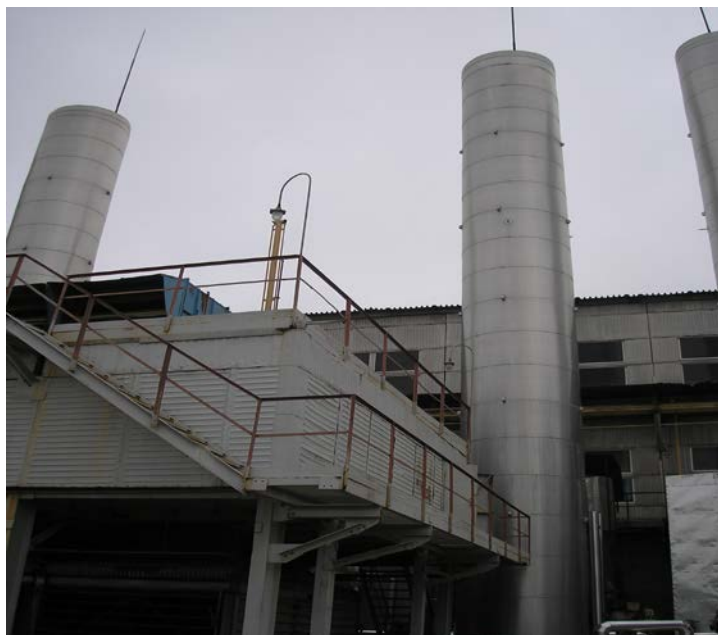
Рисунок Б.3 – Металеві димові труби КС «Задніпровська»
