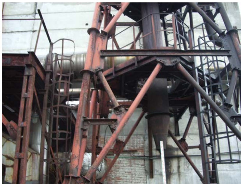
Рисунок 4.21 – Руйнування захисного лакофарбового покриття, місцеві згини розпірки і розкосу, поверхнева корозія елементів вежі.
