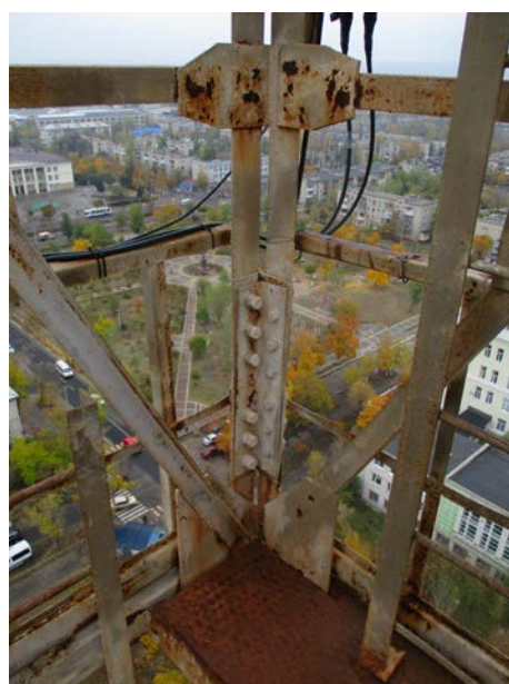
Рисунок 4.22 – Руйнування захисного лакофарбового покриття:
