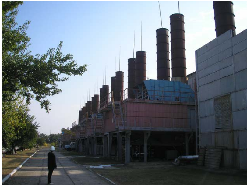
Рисунок 4.1 – Металеві димові труби КС «Південнобузька»
