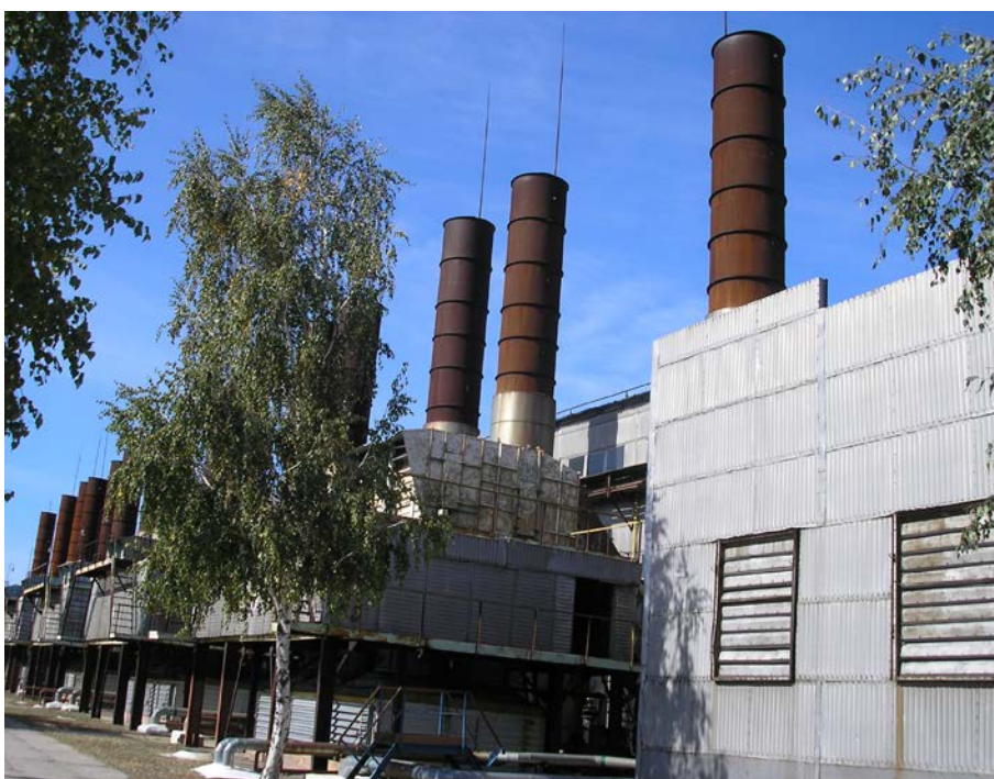
Рисунок 4.5 – Металеві димові труби КС «Кіровоградська»
