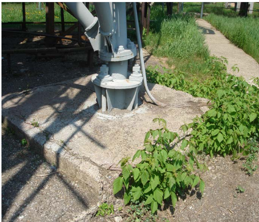
Рисунок 4.27 – Утрата стійкості фасонки опорного розкосу вежі
