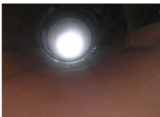
Рисунок 4.11 – Руйнування захисного лакофарбового покриття більш ніж 30% поверхні стовбура труби, поверхнева корозія металу труб:
