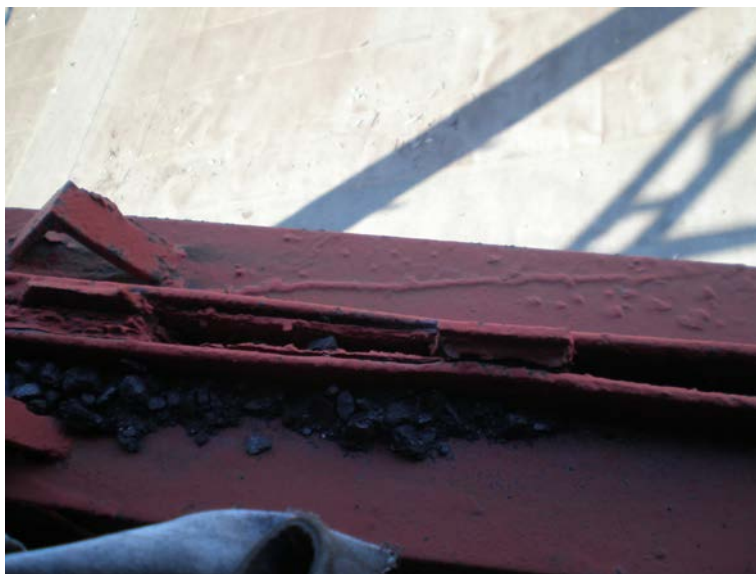
Рисунок 4.24 – Міжщилинна корозія між парними кутиками розпірки вежі, зварні шви зруйновані
