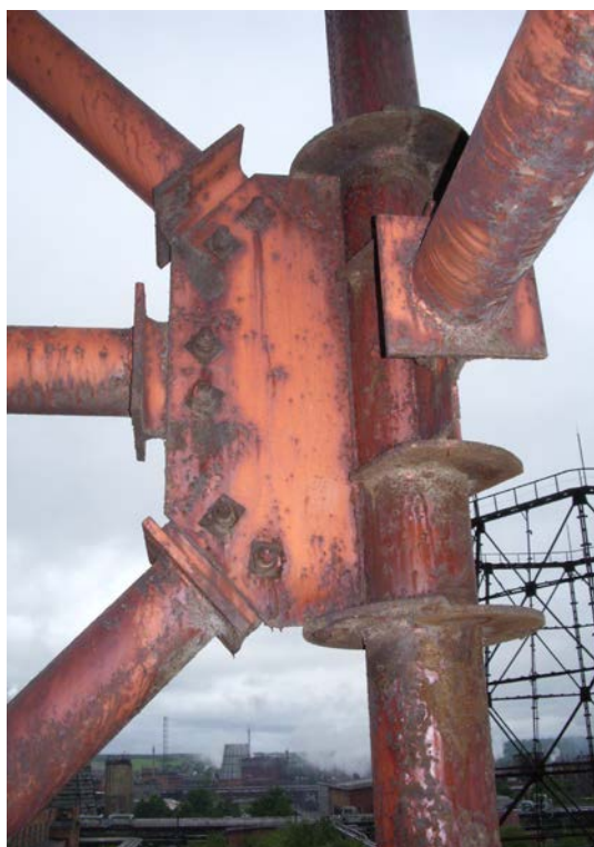
Рисунок 4.25 – Руйнування захисного лакофарбового покриття, тріщини у зварних швах кріплення розкосів і фасонки
