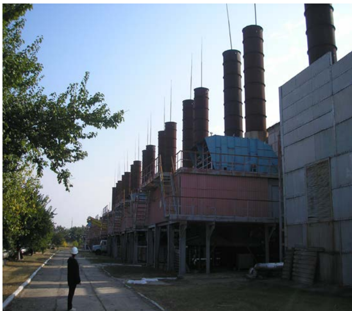
Рисунок Б.1 – Металеві димові труби КС «Південнобузька»
