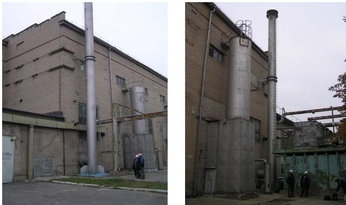
Рисунок Б.10 – Металеві вентиляційні труби висотою 19.87 м забору повітря енергетичного цеху
