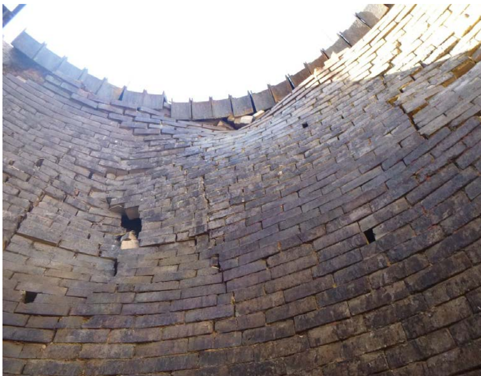
Рисунок 4.20 – Пошкодження кладки футеровки у трубі:
