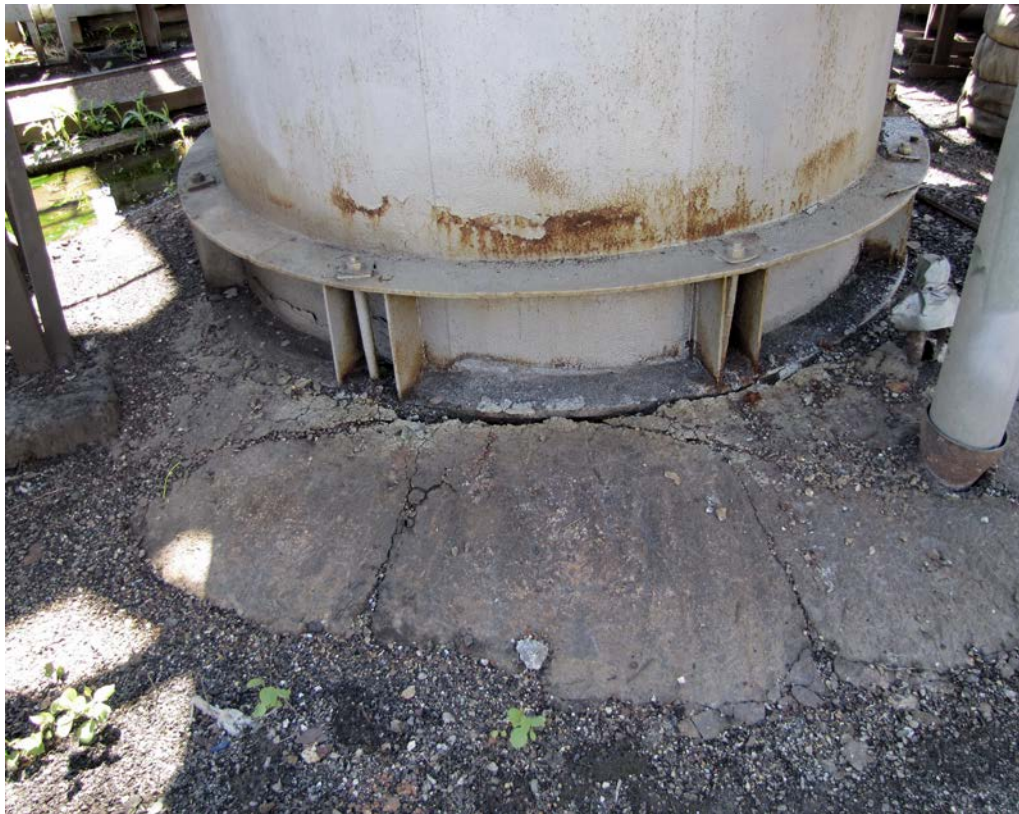
Рисунок 4.19 – Тріщини в бетоні шириною розкриття до 5 мм, руйнування бетону фундаменту під трубу
